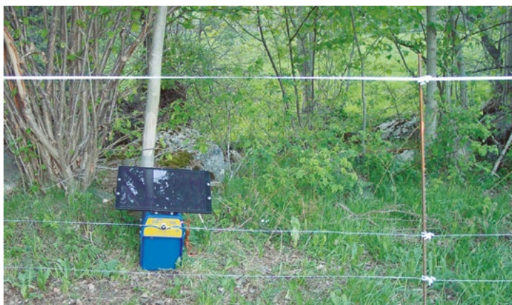
Figura 3.4. Sistema de subministrament d'energia amb bateries i plaques solars.
